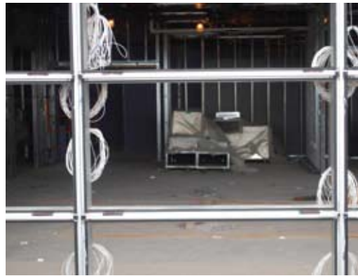
图5 开口已经准备好，可以安装利用电致变色技术的IGU。相关部件已经在位，窗框线束已经事先接好，孔已密封。
